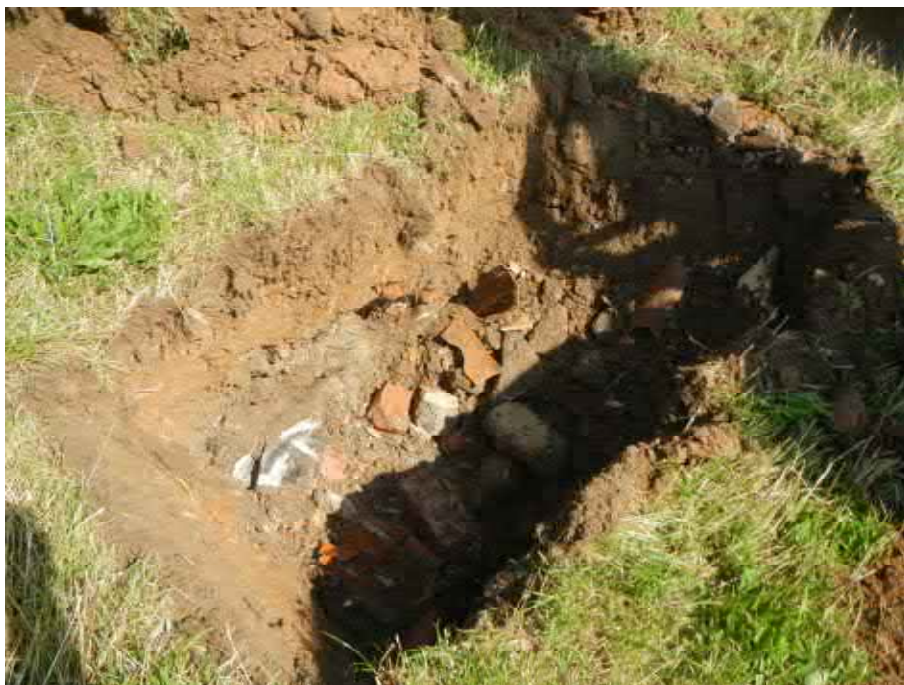
Fotos 9-10: AA „Am Bettacker“, Berghaupten, Schurf BS 5 am 26.06.2019 Auffüllung mit hohem Anteil an Bauschutt
