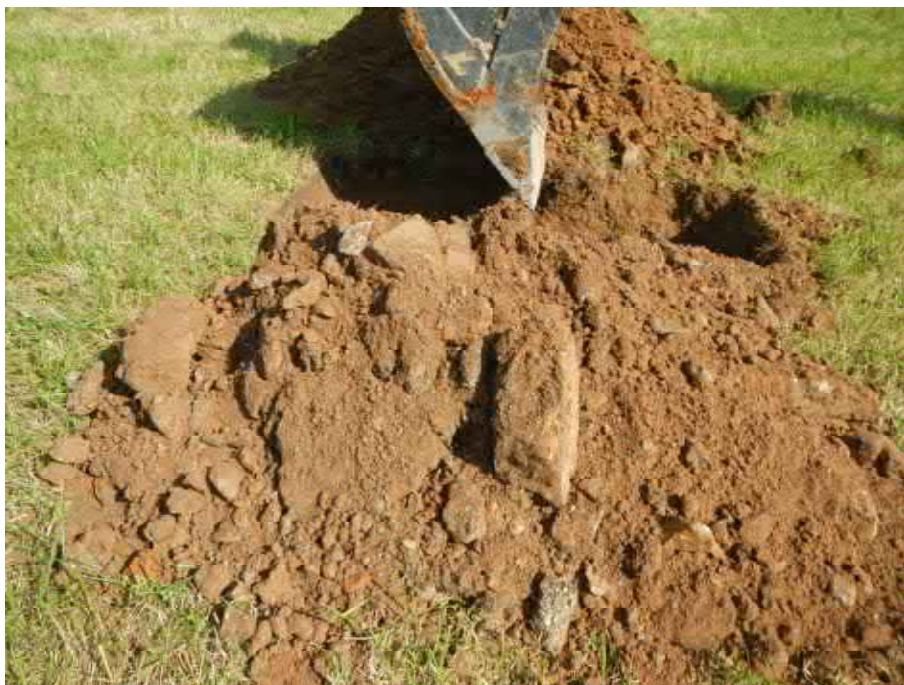
Fotos 7-8: AA „Am Bettacker“, Berghaupten, Schurf BS 4 am 26.06.2019 Auffüllung mit Betonblöcken, Ziegel, Ziegel, Bausteine
