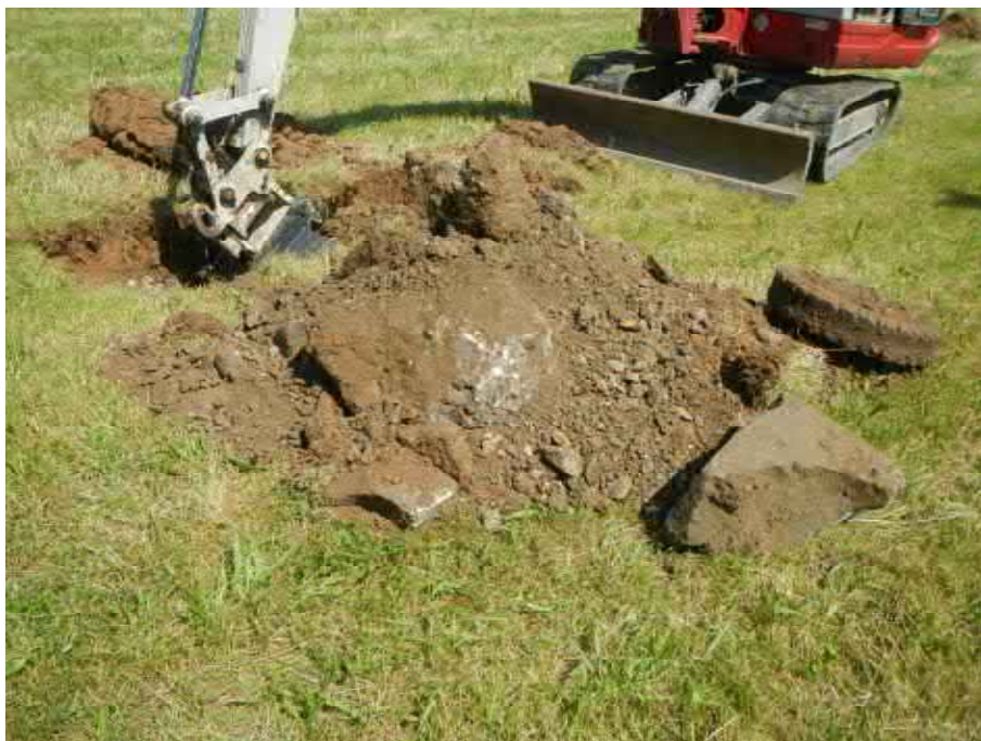
Fotos 11-12: AA „Am Bettacker“, Berghaupten, Schurf BS 6 am 26.06.2019 Auffüllung mit hohem Anteil an Betonblöcken
